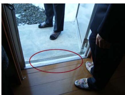
非常口の段差
