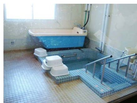
改修が必要な浴室
